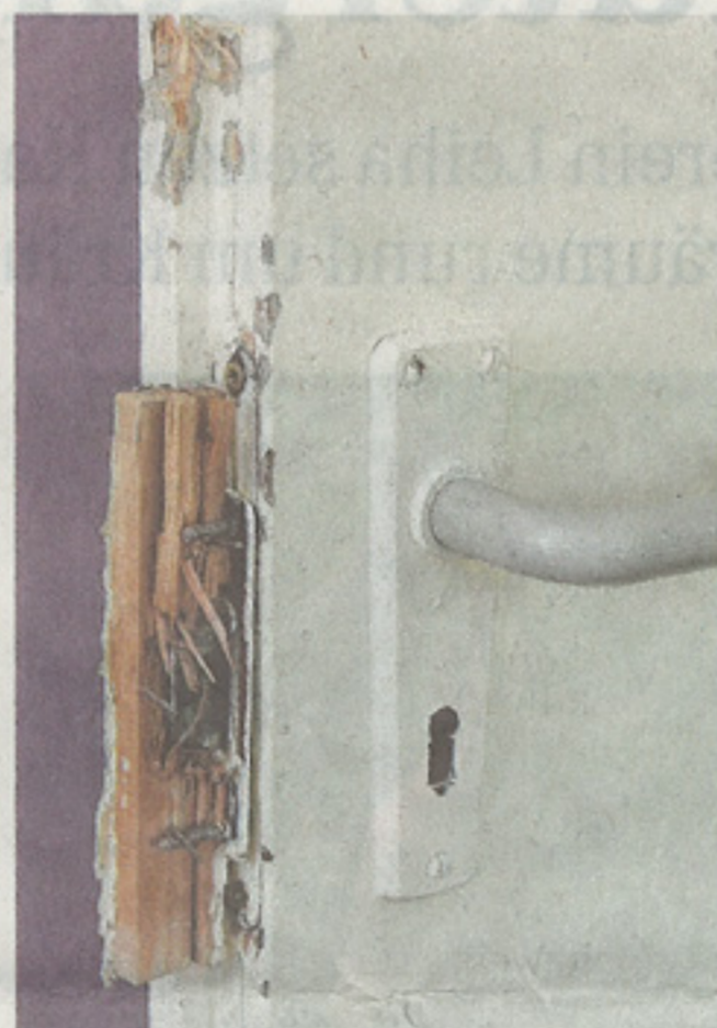
Die Einbrecher ramponierten Türen.
